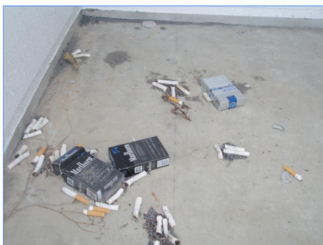
写真5 新校舎非常階段下の隠れ喫煙事例 (平成23年7月)
